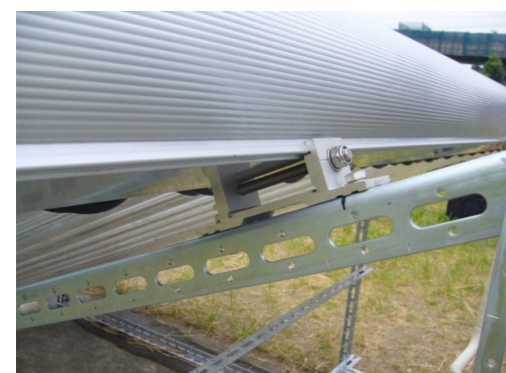
架台との接続(ヘッダー部)
