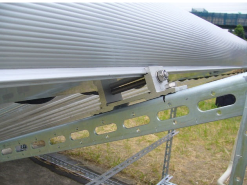
架台との接続(ヘッダー部)
